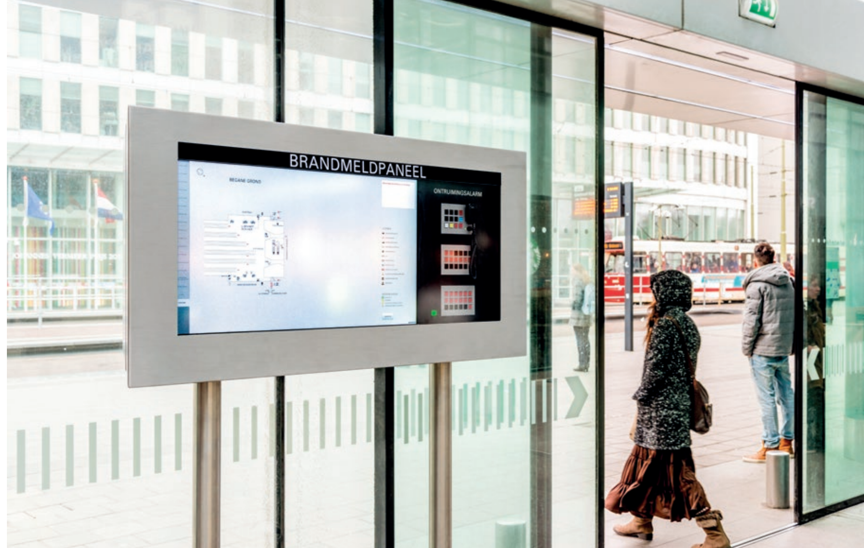
Brandmeldpaneel in de nieuwe OV Terminal in Den Haag
