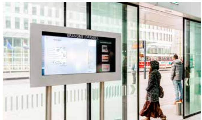
Digitaal brandmeldpaneel in nieuwe terminal Den Haag
